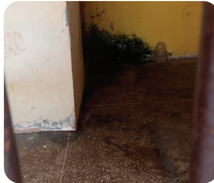
Foto 3 • Mofo em parede da Centro Educacional Dom Bosco
