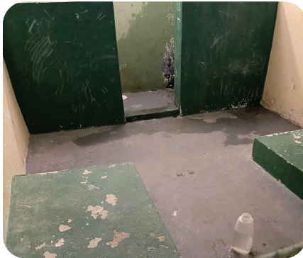
Foto 2 • Umidade em quarto com banheiro de unidade socioeducativa
